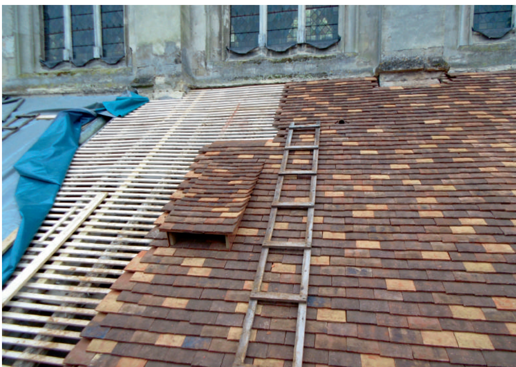
Aménagement d'une chiroptière au niveau de la toiture de l'église de Montfort-l'Amaury (Arnaud Bak, PNR de la Haute Vallée de Chevreuse)
